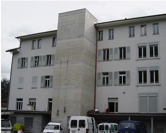
Noyau de renforcement de la rigidité transversale et longitudinale.
